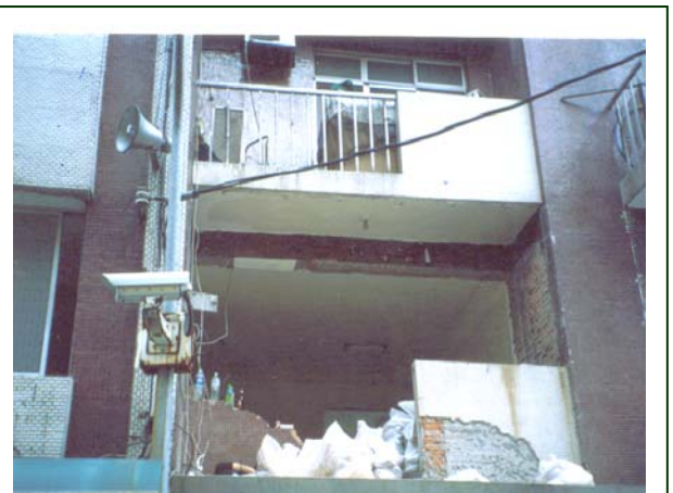
▲ 擅自拆除連接陽台之外牆（陽台外推）已構成違章建築行為
