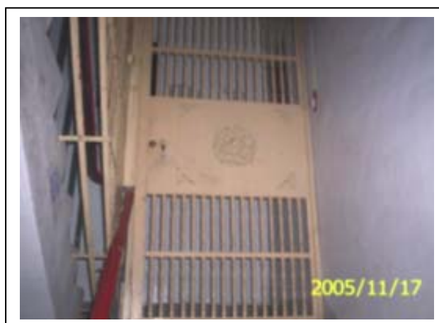
▲ 安全梯間擅自設置柵門違反公寓大廈管理條例第 16 條規定
